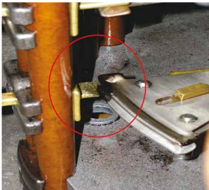
Zdj. 2. Upalony styk stały na klatce wybierakowej z widocznymi śladami
