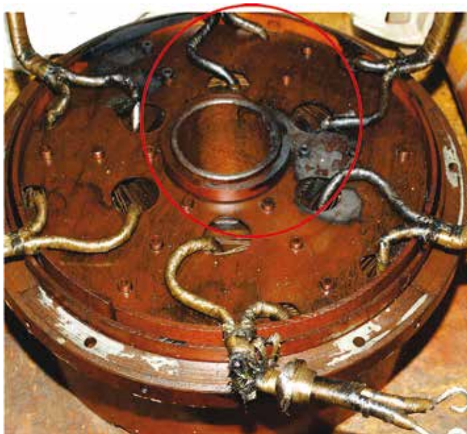
Zdj. 3. Widok oporników stopniowych z widocznymi śladami przegrzania
